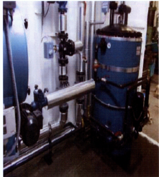
Εικόνα 3.6 Λέβητα για την παραγωγή ατμού 2
