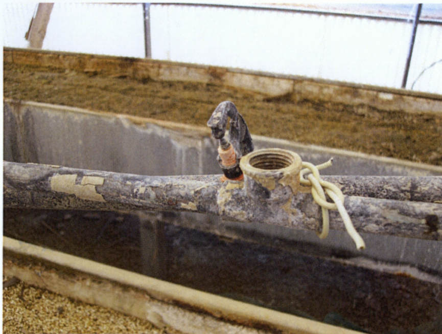
Εικ.34 Σύστημα υδρονέφωσης
