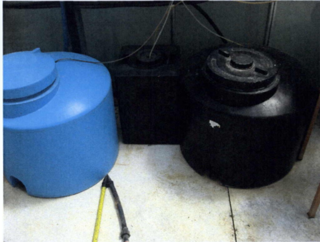
Εικόνα 14: δεξαμενές πυκνών διαλυμάτων και οξυ.
