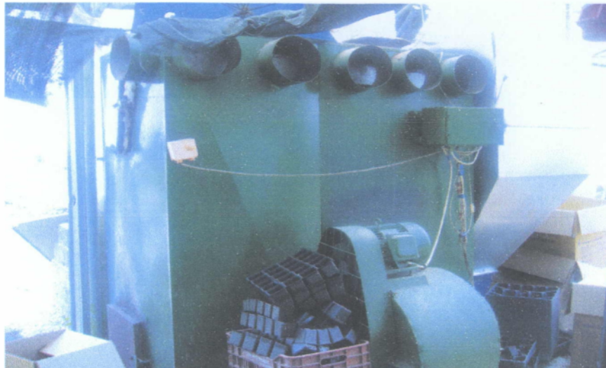
Εικ. 9: Αερόθερμο με καύση πυρηνόξυλο. (Προσωπικό αρχείο)
