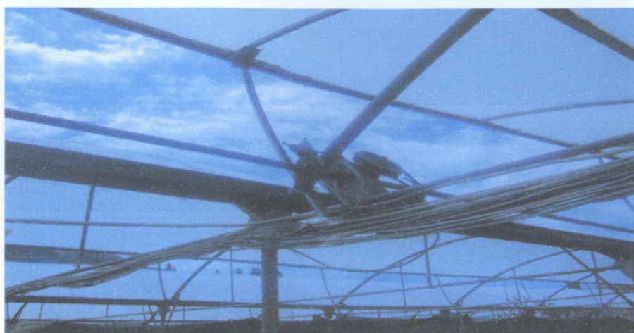
Εικ. 7: Φυσικός εξαερισμός με ηλεκτρικά ανοίγματα οροφής.(Προσωπικό αρχείο).
