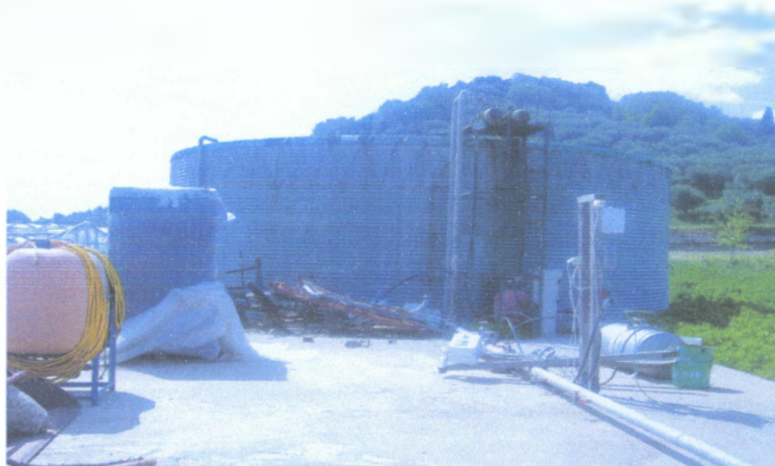
Εικ.11: Δεξαμενή κεντρικού συστήματος άρδευσης (Προσωπικό αρχείο).
