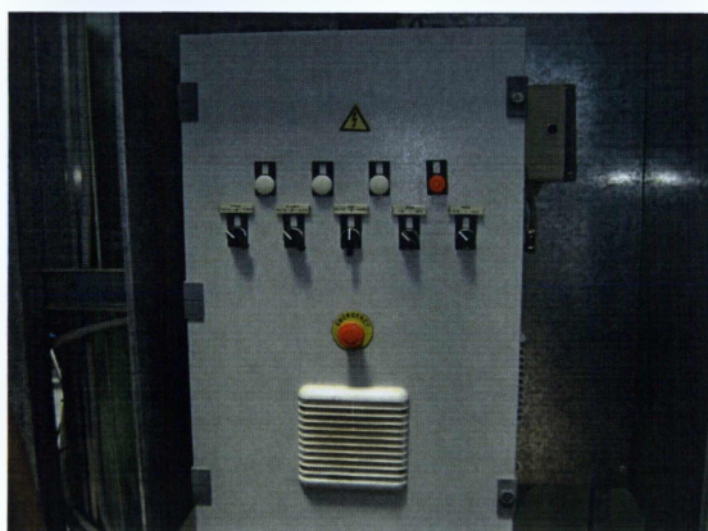
Εικόνα 2: Ηλεκτρικός πίνακας, ελέγχου λειτουργίας floating, υδρονέφωσης και ανεμιστήρων.
