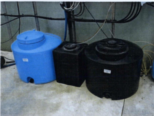
Εικόνα 6: Δεξαμενές πυκνών διαλυμάτων
