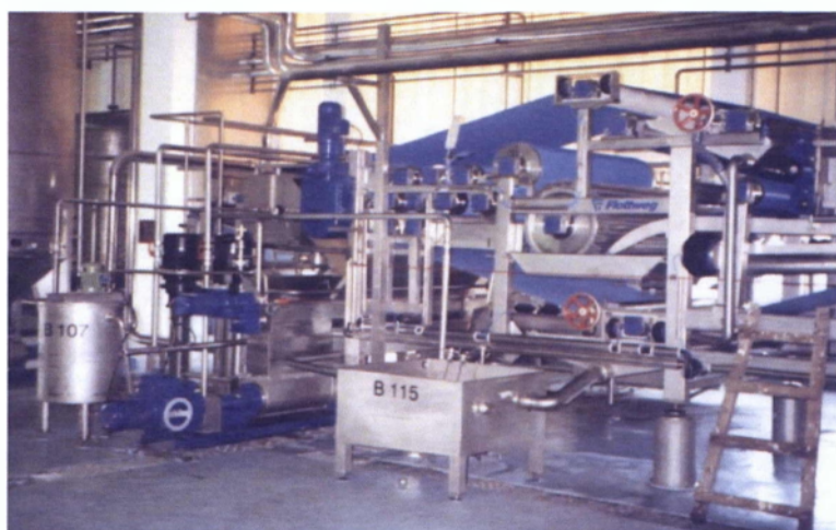
Εικόνα 18. Μηχάνημα εκθλίψεως-παραγωγής λαδιού
