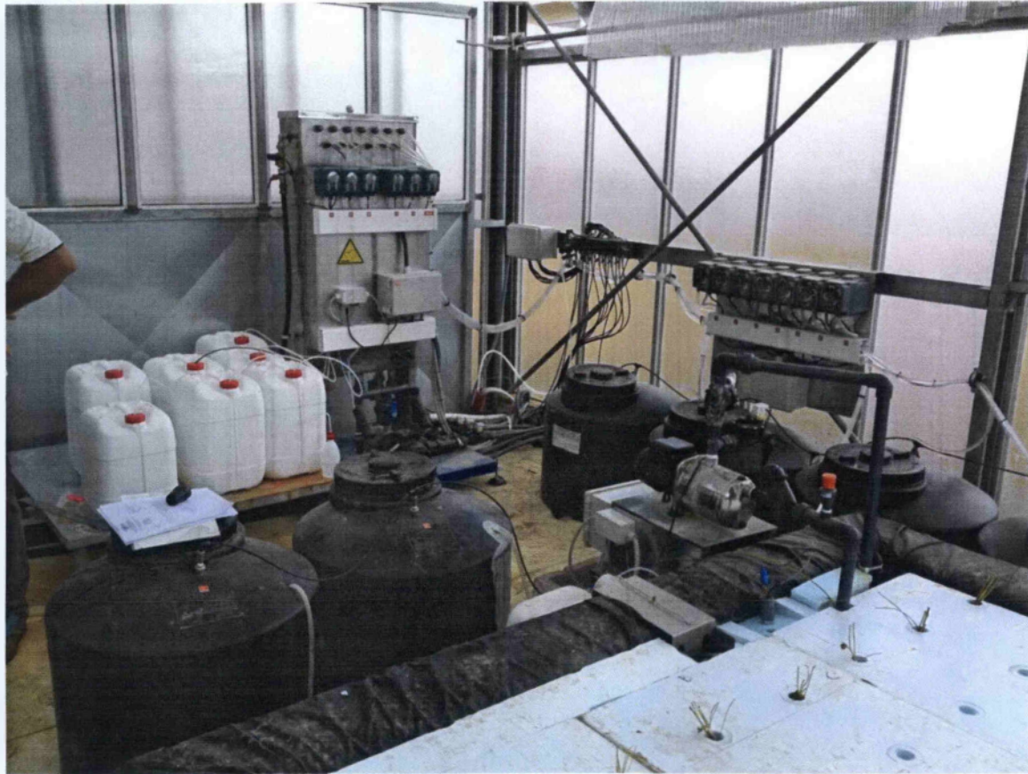
Εικόνα 7.2.3 Κεφαλή υδρολίπανσης και Δοχεία πυκνών διαλυμάτων
