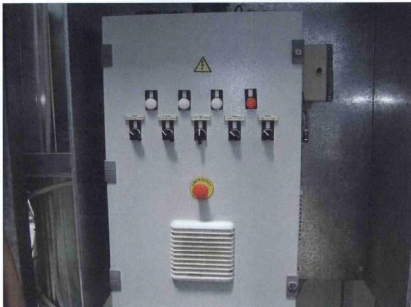
(φώτο 37) - ηλεκτρικός πίνακας
