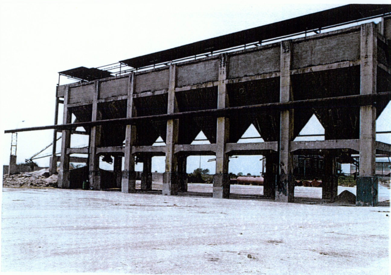
Εικ. 27 Σηλό αποθήκευσης νωπού ποητού
