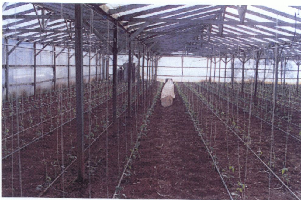
Φωτο1. Σύστημα θέρμανσης
