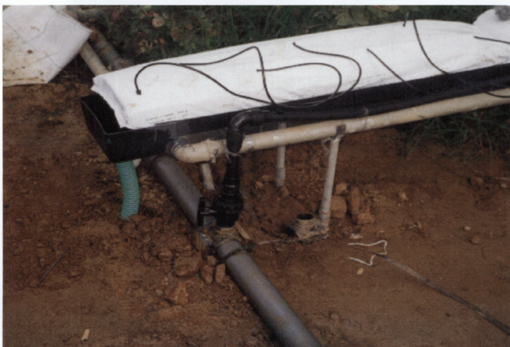
Συλλεκτικός αγωγός απορροής θρεπτικού διαλύματος
