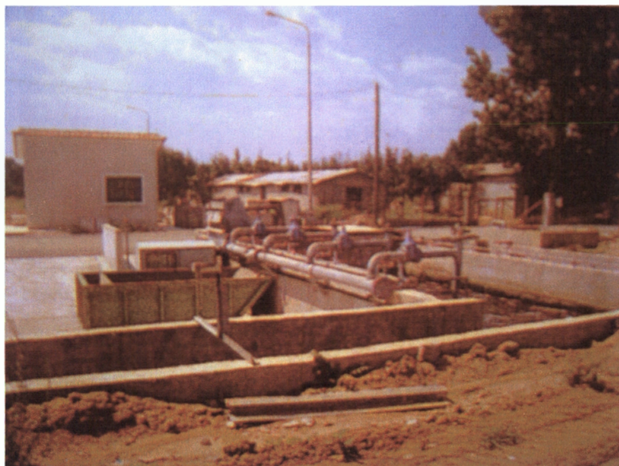
Εικόνα 1.2. Έργα εισόδου στο βιολογικό καθαρισμό Καρδίτσας.
