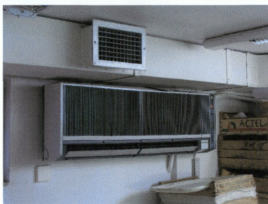
Εικόνα19 : Τμήμα του εντομοτροφείου, διακρίνεται απαγωγός αέρος και κλιματιστικό μηχάνημα.
