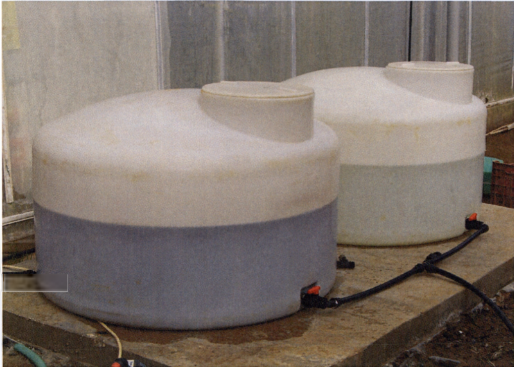
Εικόνα 4. Οι δεξαμενές που περιέχονται τα λιπάσματα σε μορφή διαλύματος. Παρατηρούμε ότι σωστά βρίσκονται πάνω σε τσιμεντένια βάση.
