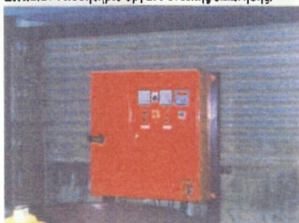
ΕΙΚ.2.28 Ηλεκτρικός πίνακας αυτοματισμού του ανεμομεικτη.
