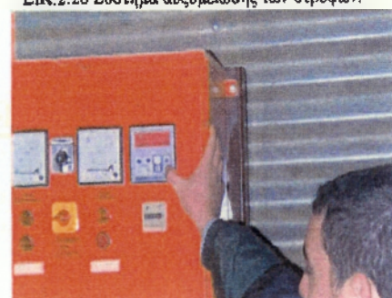
ΕΙΚ.2.29 Ρύθμιση θερμοκρασίας εκκίνησης του ανεμομεικτη
