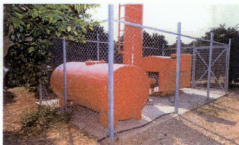
ΕΙΚ.2.31 Δεξαμενή καυσίμων ανεμομεικτη.
