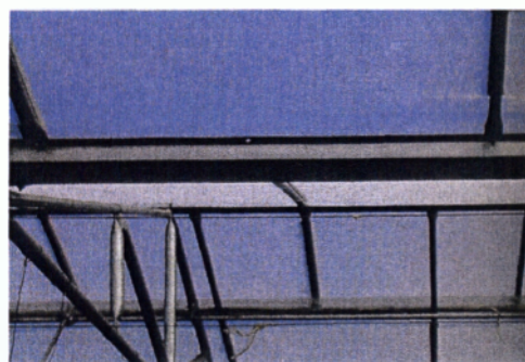
Εικόνα 25. Υδρορροή από αλουμίνιο στο θερμοκήπιο της εκμετάλλευσης.
