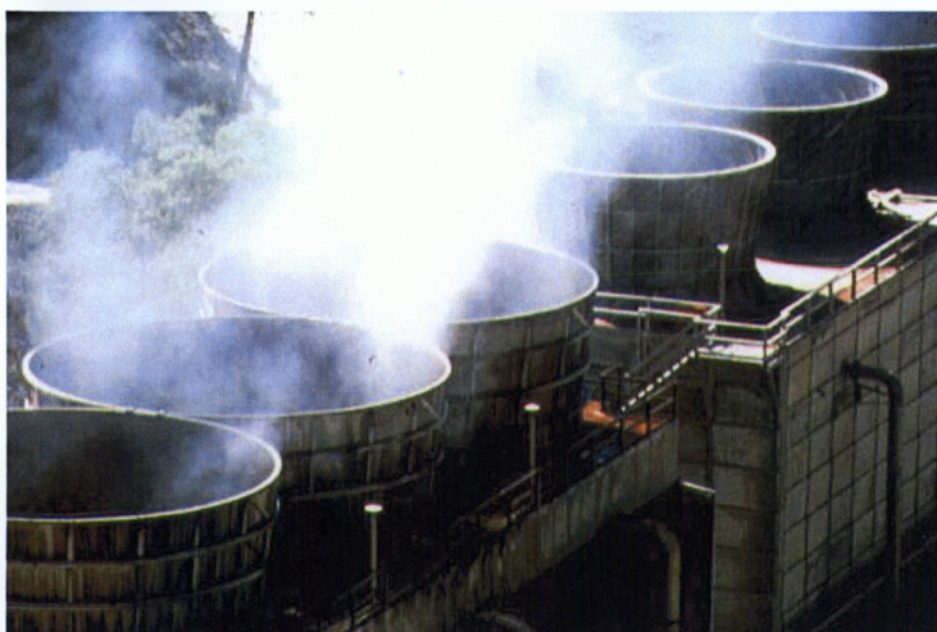
Εικ.6 Μονάδα εκμετάλλευσης Γεωθερμίας
