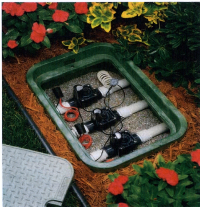
Εικόνα 2.3.2: Φρεάτιο και Ηλεκτροβάνες
