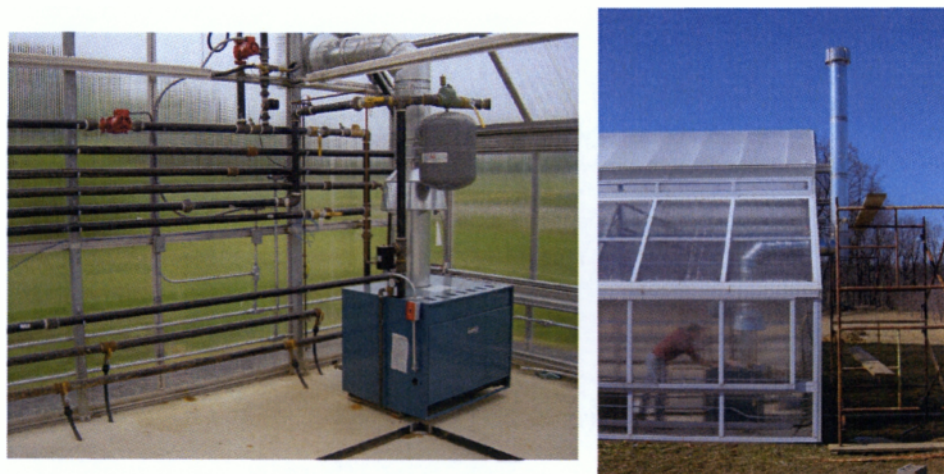
Εικόνα 5.4. Ολοκληρωμένο πλευρικό σύστημα θέρμανσης.
