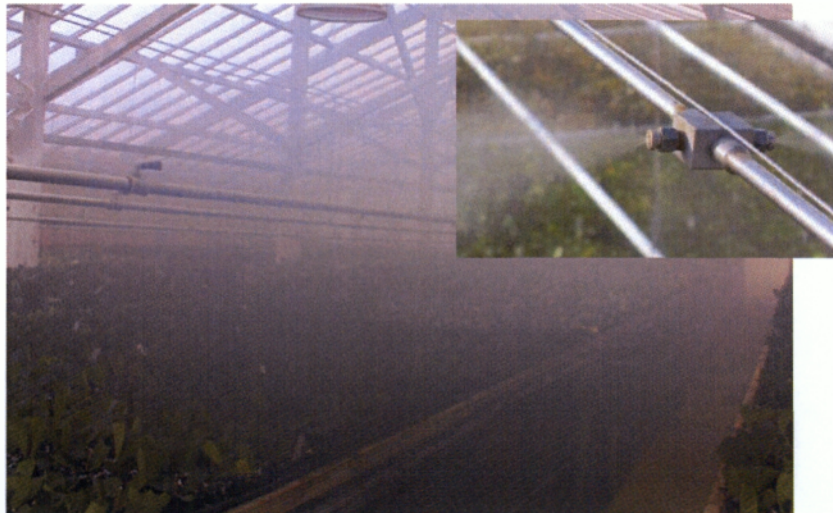
Εικόνα 4.1. Υδρονέφωση θερμοκηπίου για αύξηση σχ.υγρ.
