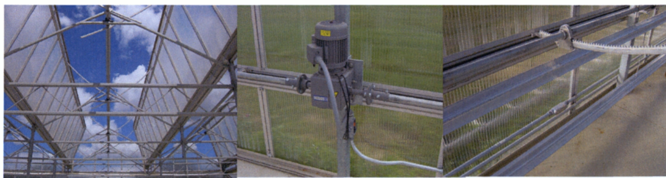
Εικόνα 5.8. Φυσικός αερισμός με ανοίγματα οροφής και πλαϊνών παραθύρων.
