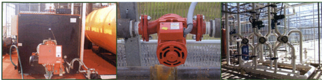
Εικόνα 5.3. Λέβητας με καυστήρα, κυκλοφορητής και βαλβίδες
