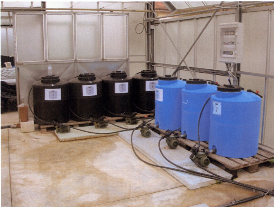
ΕΙΚΟΝΑ 4.2: Η μονάδα άντλησης και αραίωσης πυκνών διαλυμάτων που χρησιμοποιήθηκε στο πείραμα.
