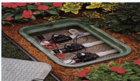
Εικόνα 176 Ηλεκτροβαλβίδες στο φρεάτιο
