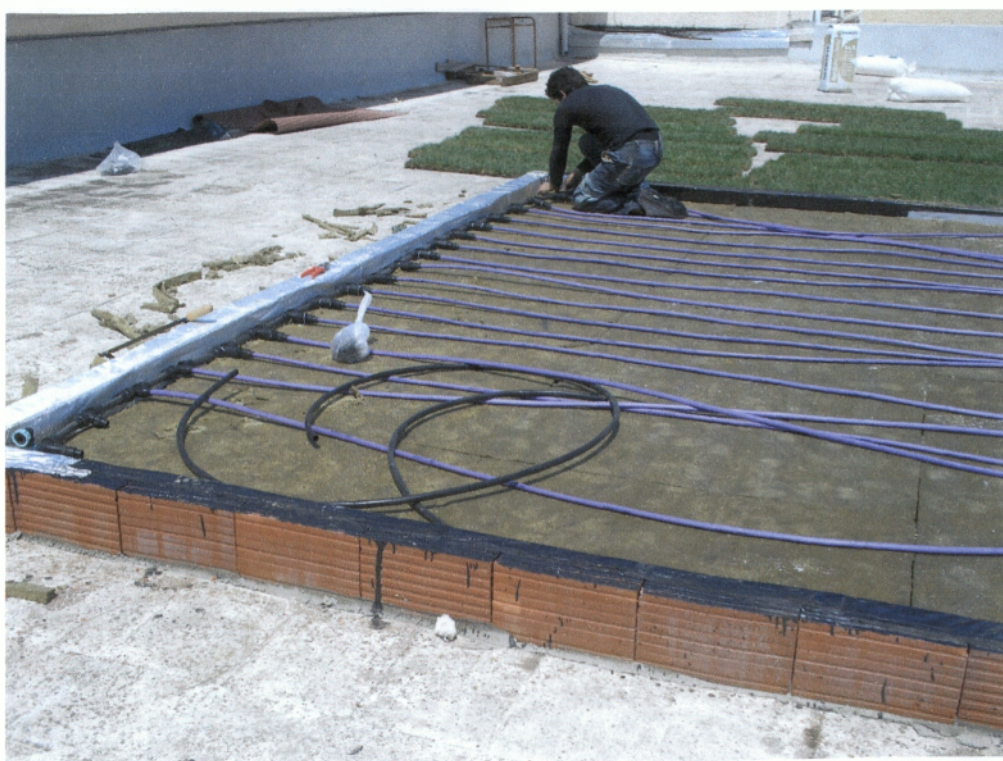
Εικ 4.7. υπόγειο σύστημα άρδευσης ταρατσόκηπου στο ΑΤΕΙ Καλαμάτας. (Ταρατσόκηπος ΑΤΕΙ Καλαμάτας, 2007)
