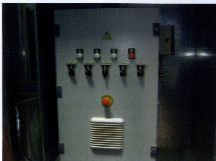
Εικόνα 2: Ηλεκτρικός πίνακας, floating.
