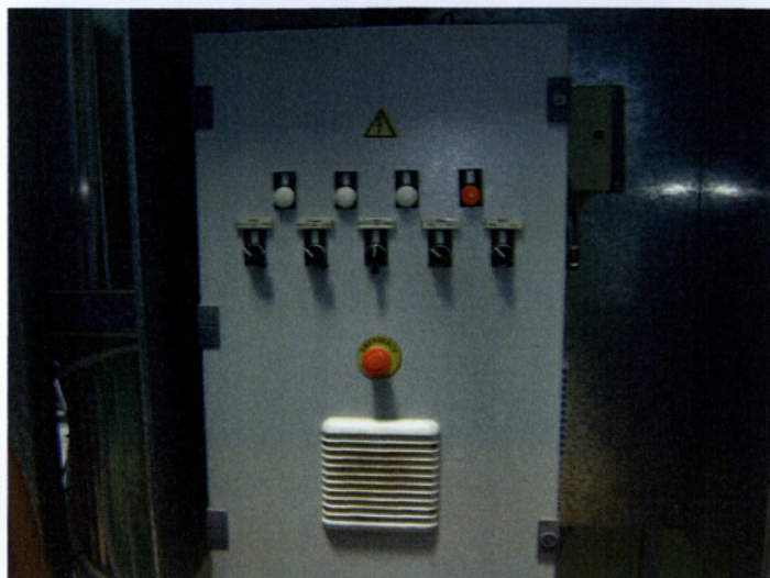
Εικόνα 1. Ηλεκτρικός πίνακας Floating,
