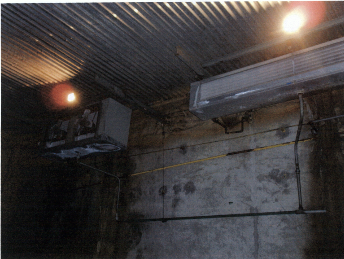
εικ. 2 Σύστημα ψύξης σε θάλαμο ελεγχόμενης ατμόσφαιρας στη Ζαγορά Πηλίου
