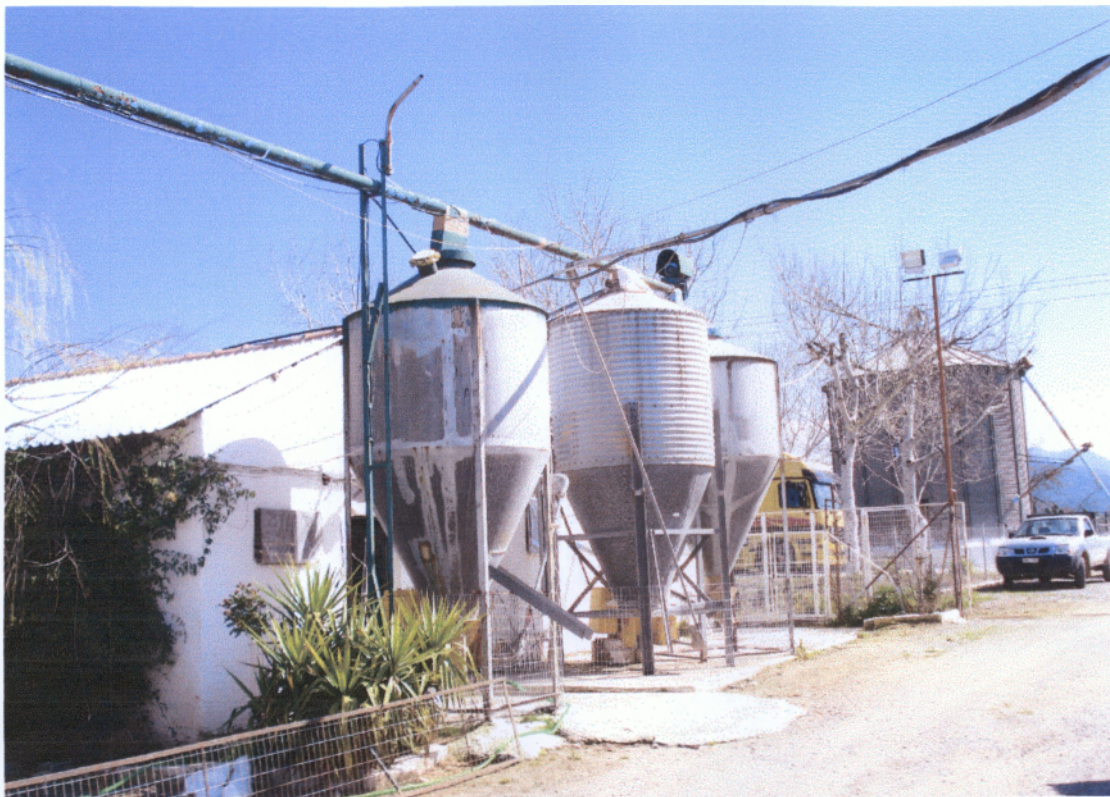
Εικόνα 6.9 Σιλό Προπάχυνσης 2 τόνων Χοιροτροφικής Μονάδας Καρύγιαννη Νικόλαου
