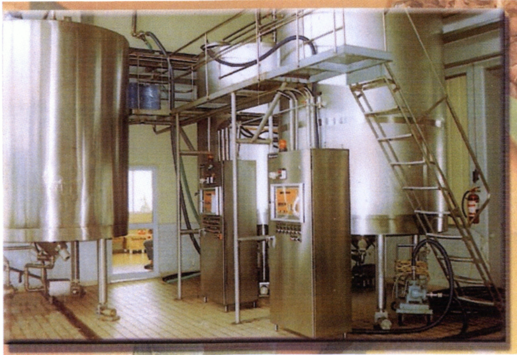
Εικόνα 1.4. Πλήρες συγκρότημα δεξαμενών
