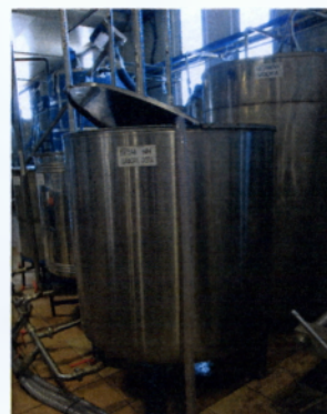
Εικόνα 6. Δεξαμενή αποθήκευσης Πηγή: Καλλικούνης, 2009
