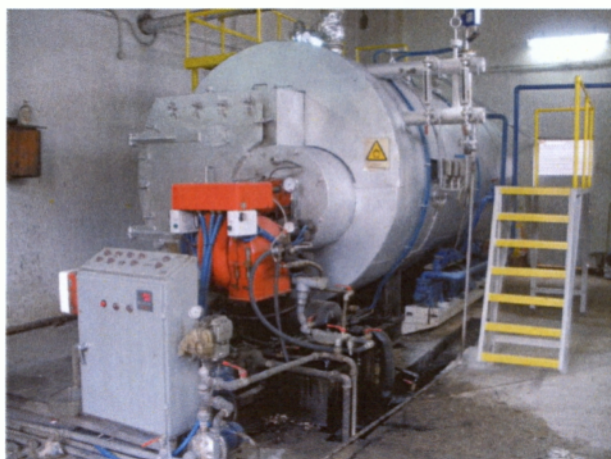
Εικόνα 54: Ατμολέβητας υψηλής πίεσης (προσωπική λήψη).
