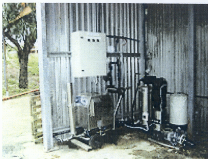
Εικόνα 2.8: Μονάδα οζονισμού υγρών αποβλήτων οινοποιείου (πηγή: http://www.mywinery.com ).
