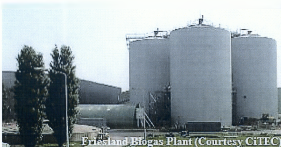
Εικόνα 2.6: Βιοαντιδραστήρες αναερόβιας χώνευσης στερεών αποβλήτων οινοποιείων προς παραγωγή βιοαερίου (πηγή: http://www.anaerobic-digestion.com/ ).
