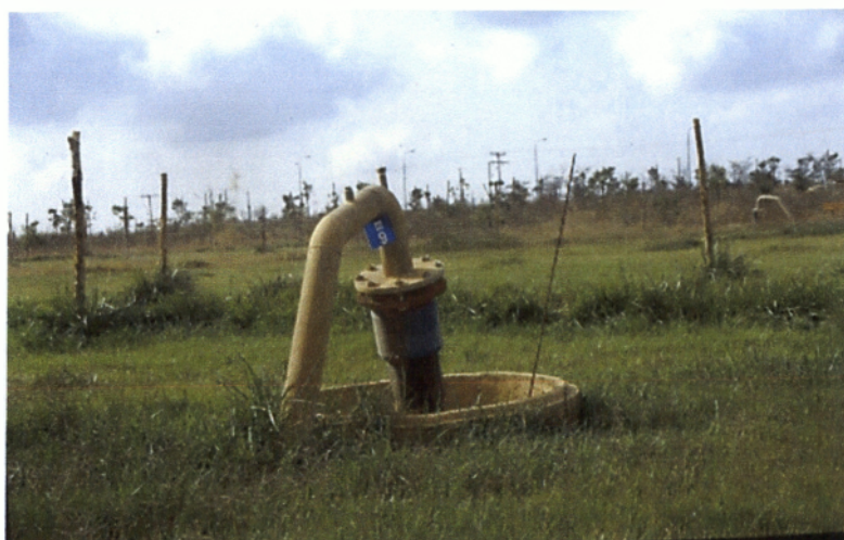
Εικόνα 8.9 : Σύστημα άντλησης και διαχείρισης βιοαερίου με 42 κατακόρυφα πηγάδια
