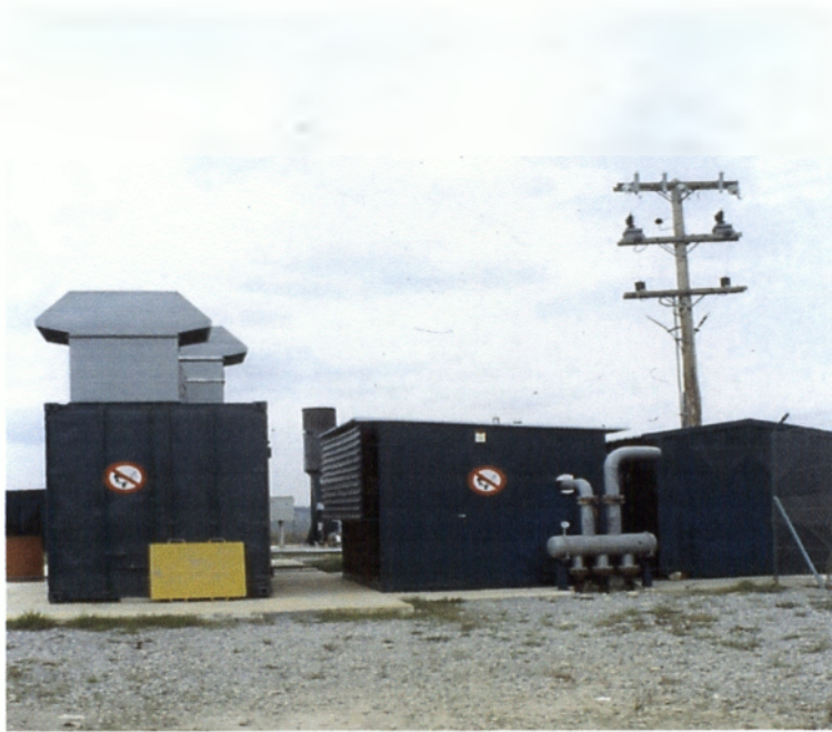
Εικόνα 8.2 : Υποσταθμός Παραγωγής Ηλεκτρικής Ενέργειας
