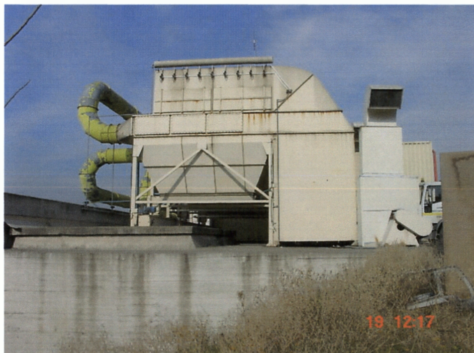
Εικόνα 7.1: Οι πάγιες εγκαταστάσεις του Σταθμού Μεταφόρτωσης Απορριμμάτων του Δήμου Θεσσαλονίκης.
