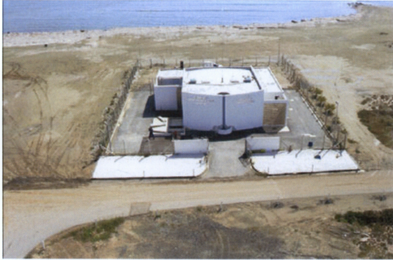
2. Αντλιοστάσιο θαλασσινού νερού
