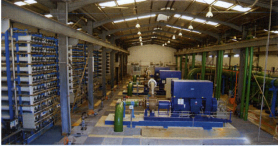
1. Αντλίες Υψηλής Πίεσης και Μονάδες Αφαλάτωσης
