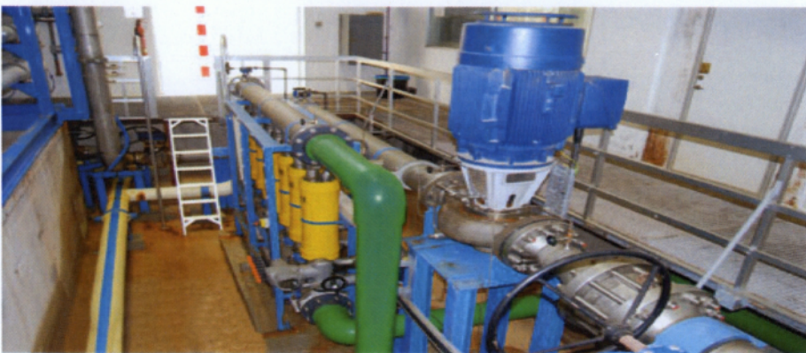
3. Συσκευές ανάκτησης ενέργειας τύπου "Pressure Exchange"
