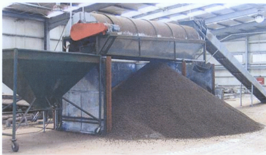
Εικόνα 1.2: Εγκατάσταση Κομποστοποίησης στο Ρέθυμνο
