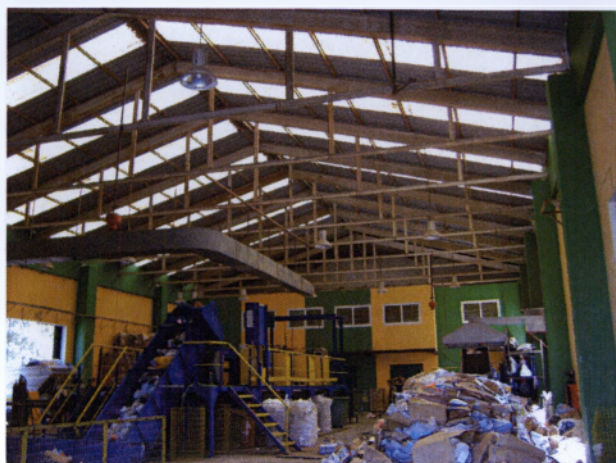
Διάταξη μηχανημάτων Κέντρου Ανακύκλωσης
