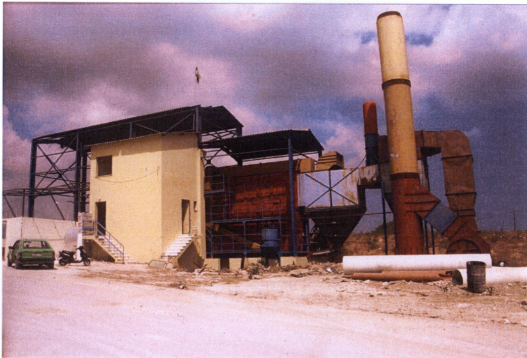
Ο καυστήρας στο δρόμο του Αεροδρομίου ο οποίος δεν λειτουργεί .
