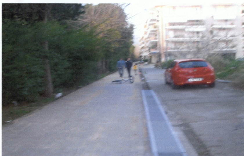
Φωτογραφία 2.11 Επικίνδυνα σημεία χωρίς μέτρα ασφαλείας στο ύψος του Πάρκου του ΟΣΕ
