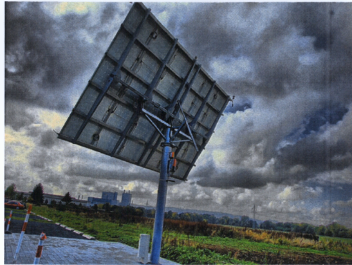
Εικόνα 5: Φωτοβολταϊκά σε ηλιοστάτη (ΠΗΓΗ : www.images.google.gr )
