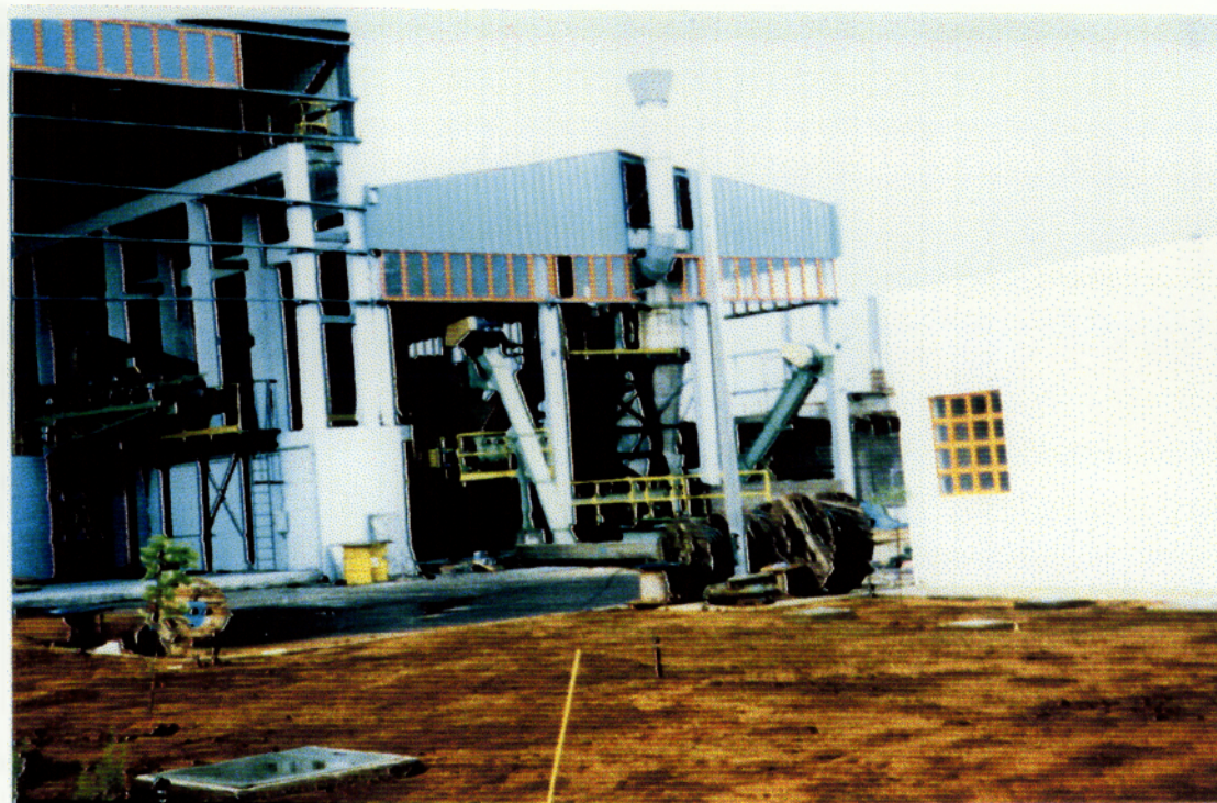
Εικόνα 12: Εγκαταστάσεις επεξεργασίας λάσπης.
