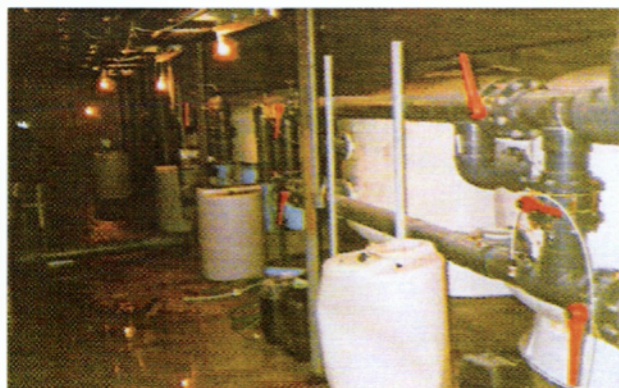
Ζημιωθείς εξοπλισμός αντλιοστασίων
