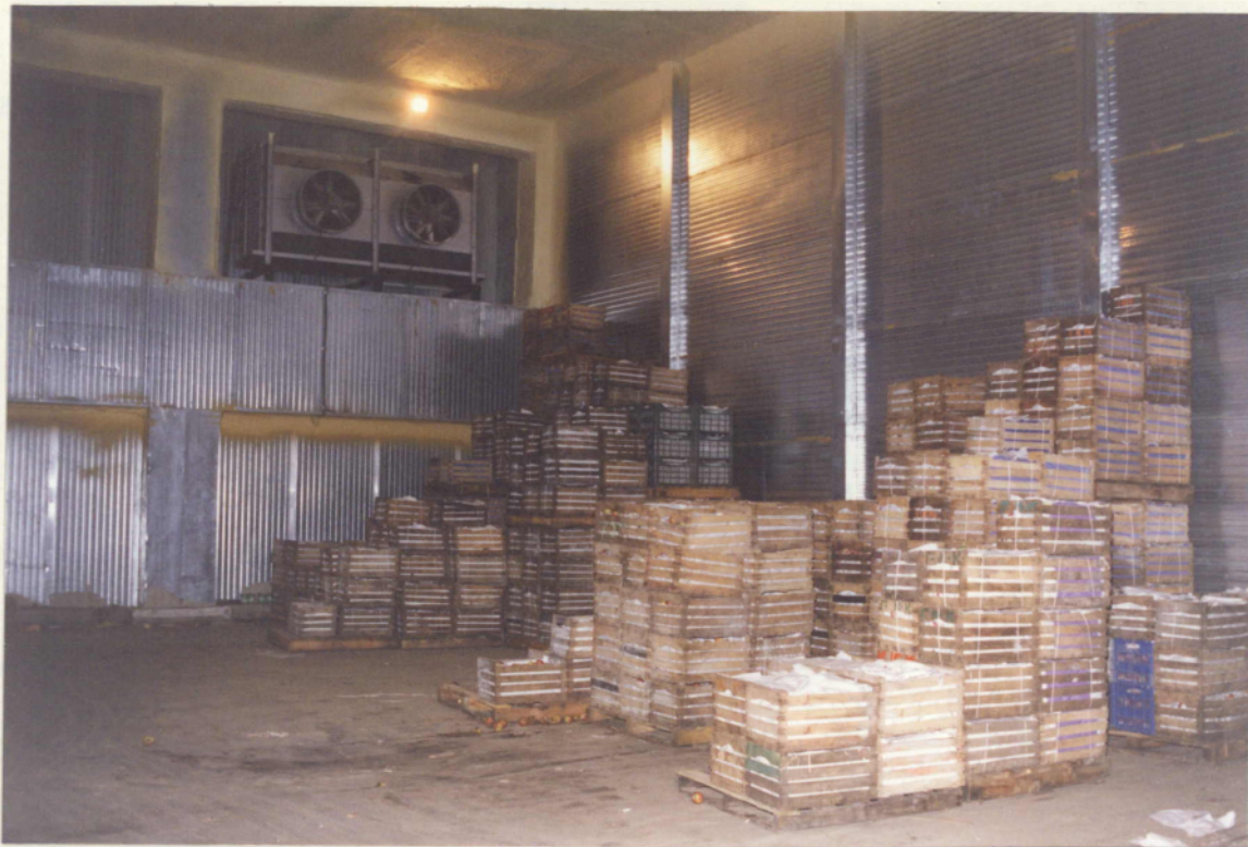
Εικόνα 8. Αποψη από ένα θάλαμο ψύξης του ψυγείου της Ε.Α.Σ.Α.
