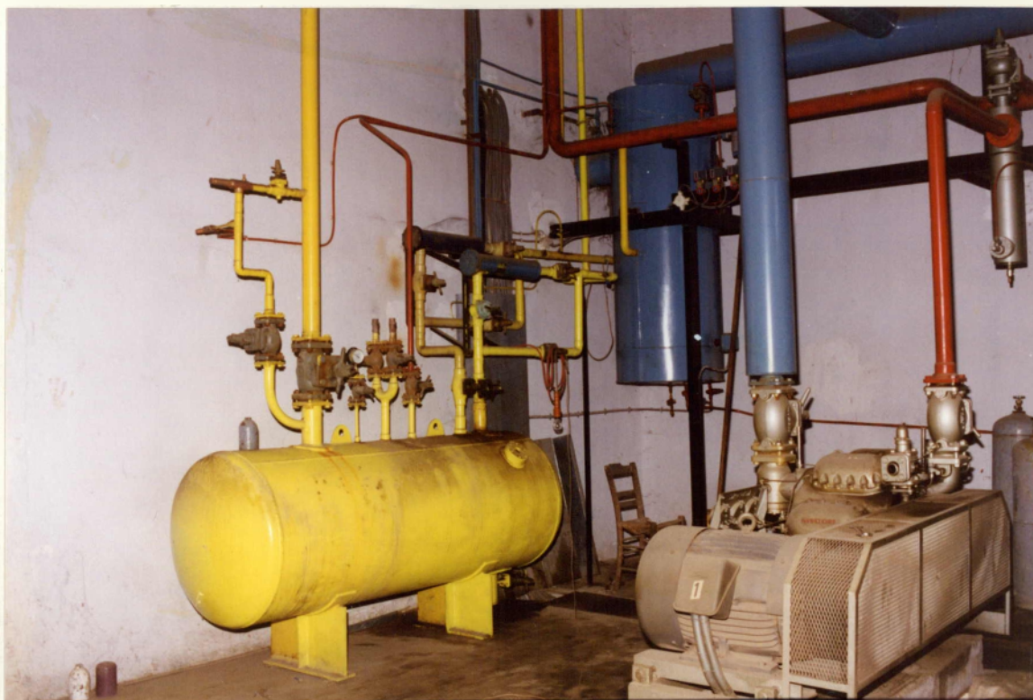
Εικόνα 4. Τμήμα από το μηχανολογικό εξοπλισμό του ψυγείου της Ε.Α.Σ.Α.
