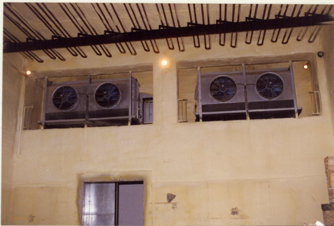
Εικόνα 9. Τμήμα θαλάμου στον οποίο φαίνονται δύο αεροψυκτήρες και οι σωλήνες του στοιχείου.
