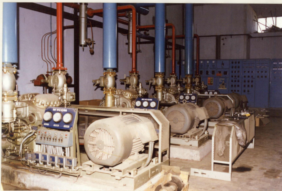
Εικόνα 5. Τμήμα από τον ηλεκτρολογικό και το μηχανολογικό εξοπλισμό της Ε.Α.Σ.Α
