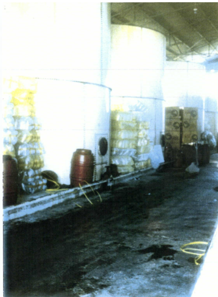
Εικόνα 18: Δεξαμενές αποθήκευσης (ΕΑΣΜ Θουρίας).
