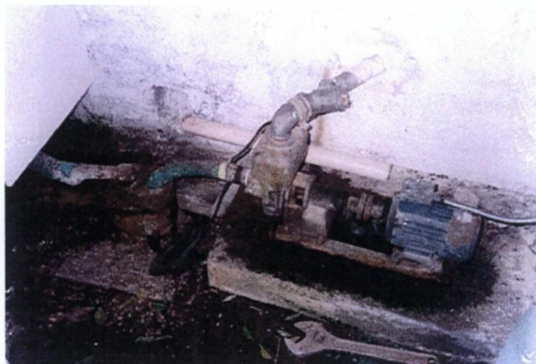
Εικόνα 59: Ο χώρος της γεώτρησης. Διακρίνεται η φυγοκεντρική αντλία με τον ηλεκτροκινητήρα και το σωλήνα αναρρόφησης
