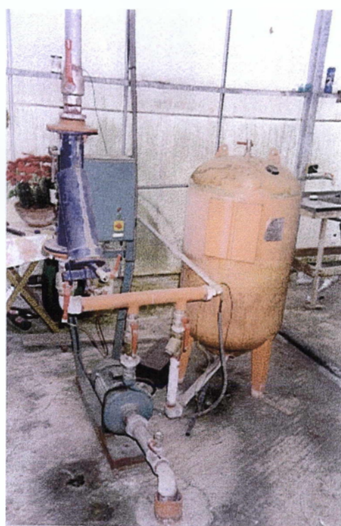
Εικόνα 54: Κεντρική εγκατάσταση άρδευσης όπου διακρίνονται: α) πιεστικό μηχάνημα, β) απλό φίλτρο σίτας, γ) Αντλία νερού από δεξαμενή θερμοκηπίου
