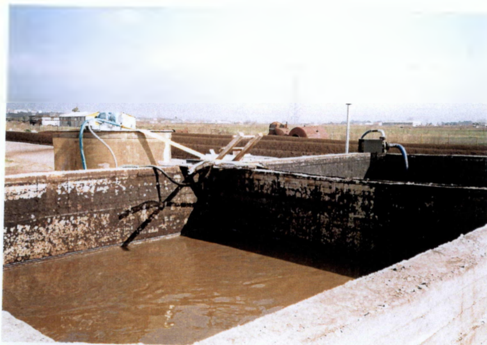
Εικόνα 3.8 "Δεξαμενές εφοδιασμένες με μηχανικό σύστημα ανάδευσης για την ανάμιξη του υλικού με οξείδιο του ασβεστίου".
