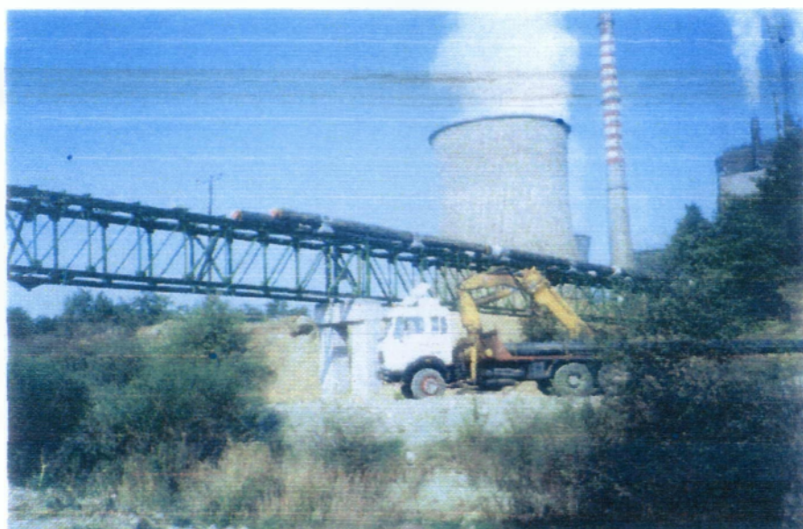
Εικόνα 2.3. Ο μεταλλικός φορέας
