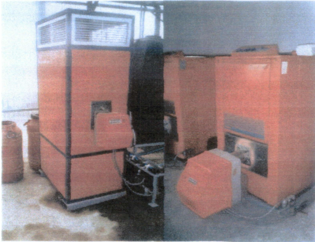
Εικόνα 5.7. Αερολέβητας θέρμανσης σπορείου και λέβητες πετρελαίου
