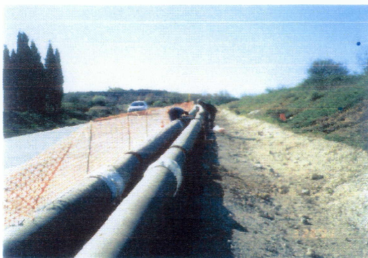
Εικόνα 2.5. Δίκτυο τροφοδότησης και επιστροφής του θερμού νερού κατά μήκος της επαρχιακής οδού.
