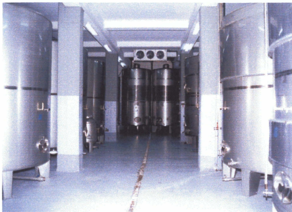
Εικόνα 12: Δεξαμενές διπλών τοιχωμάτων για αποθήκευση και ψύξη κρασιού πριν την εμφιάλωση
