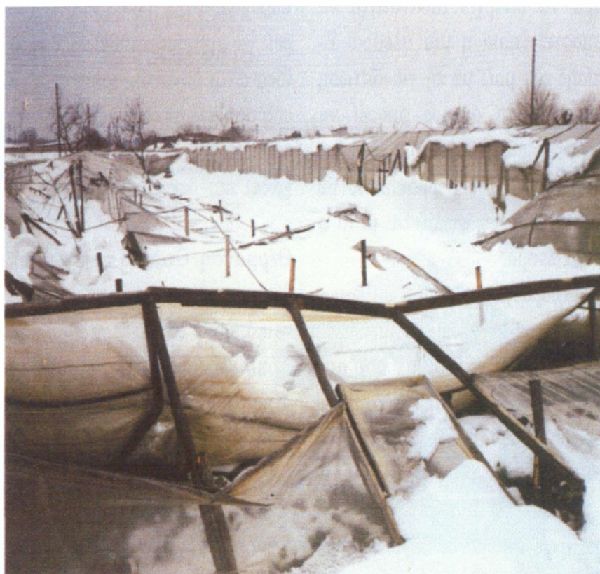
Εικόνα 2: Ολική καταστροφή θερμοκηπιακής μονάδας από ισχυρή χιονόπτωση.
