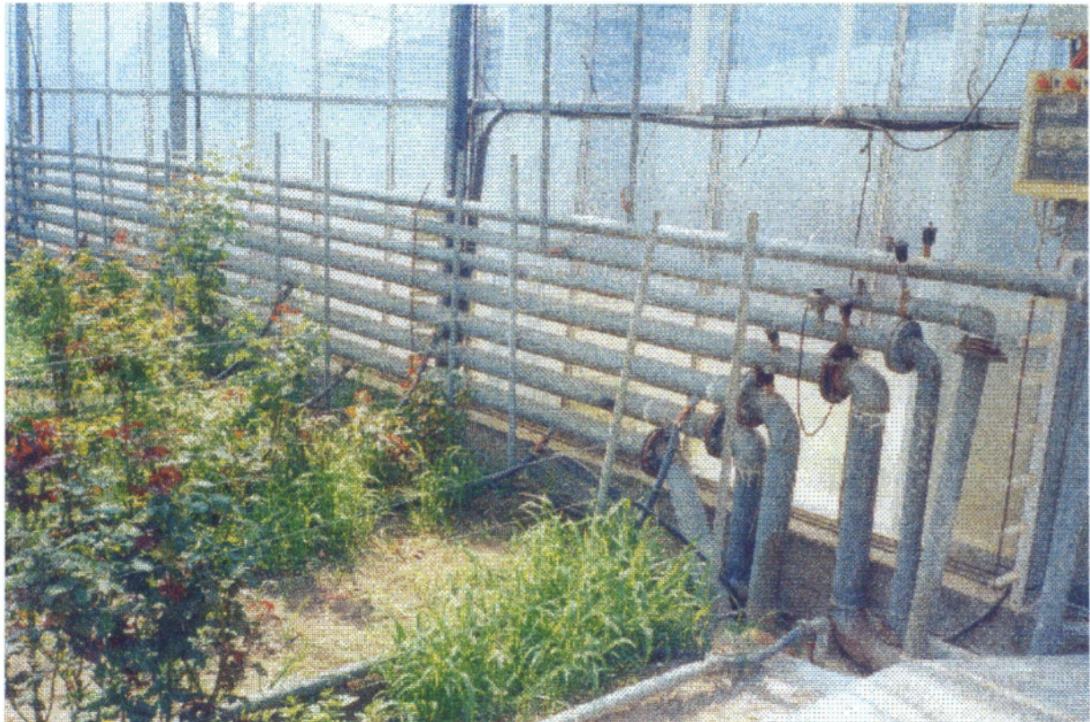
Φωτογραφία 6: Σωλήνες συστημάτων άρδευσης και θέρμανσης
