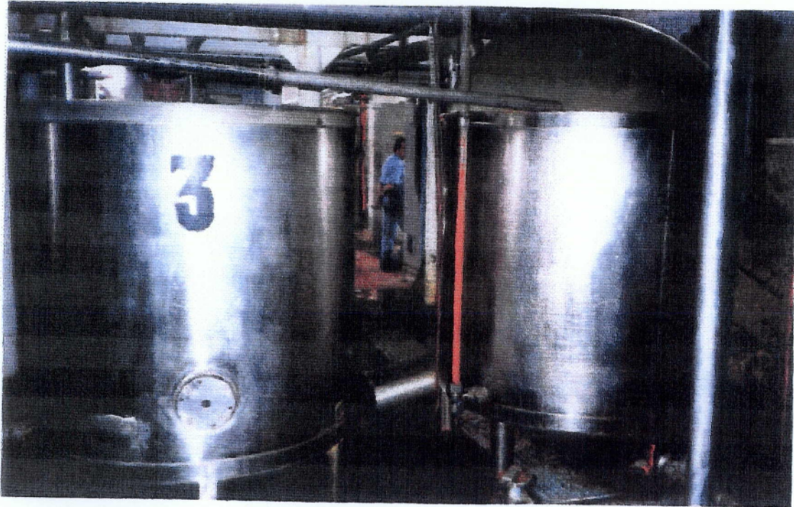
Διθητικό συγκρότημα χυμού και δεξαμενές υποδοχής.
