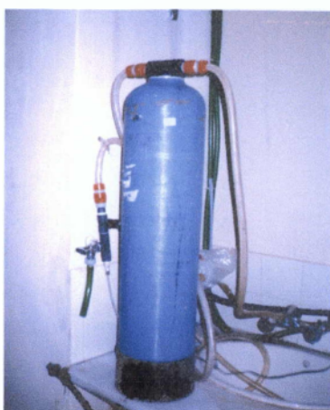
εικ. 6. Στήλη απιονισμού νερού.
