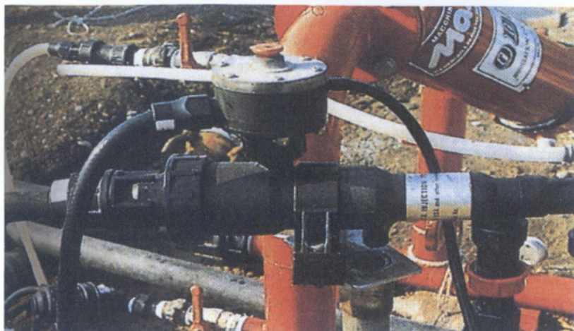
Εικ. 4.11 Μέρος της εγκατάστασης του συστήματος υδρολίπανσης
