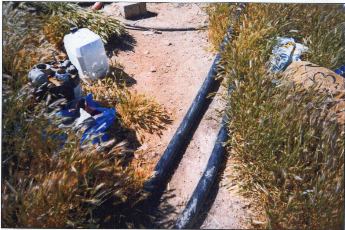
Εικόνα 11. Τμήμα μεταφοράς γεωθερμικού ρευστού
