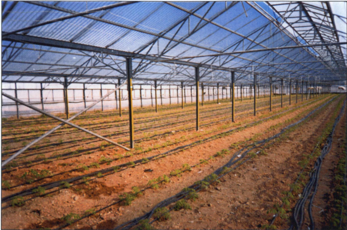
Εικόνα 21. Σωληνώσεις μεταφοράς του θερμού νερού θέρμανσης
