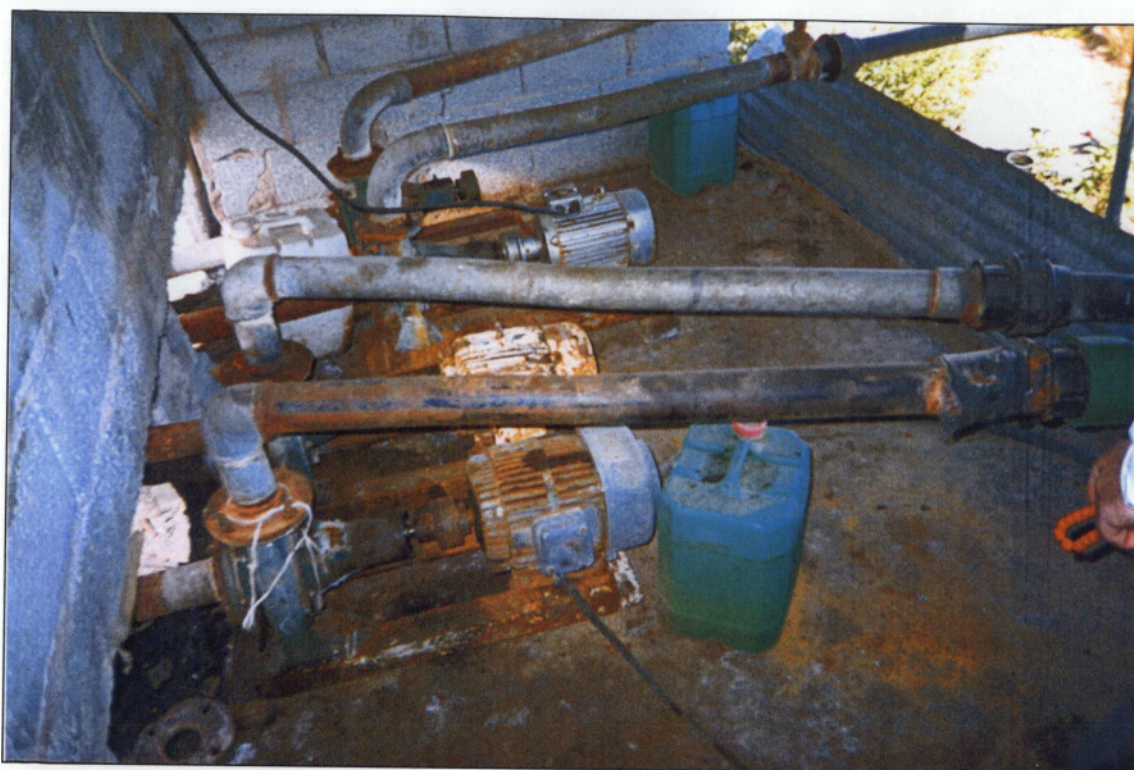
Εικόνα 9. Τμήμα μεταφοράς γεωθερμικού ρευστού
