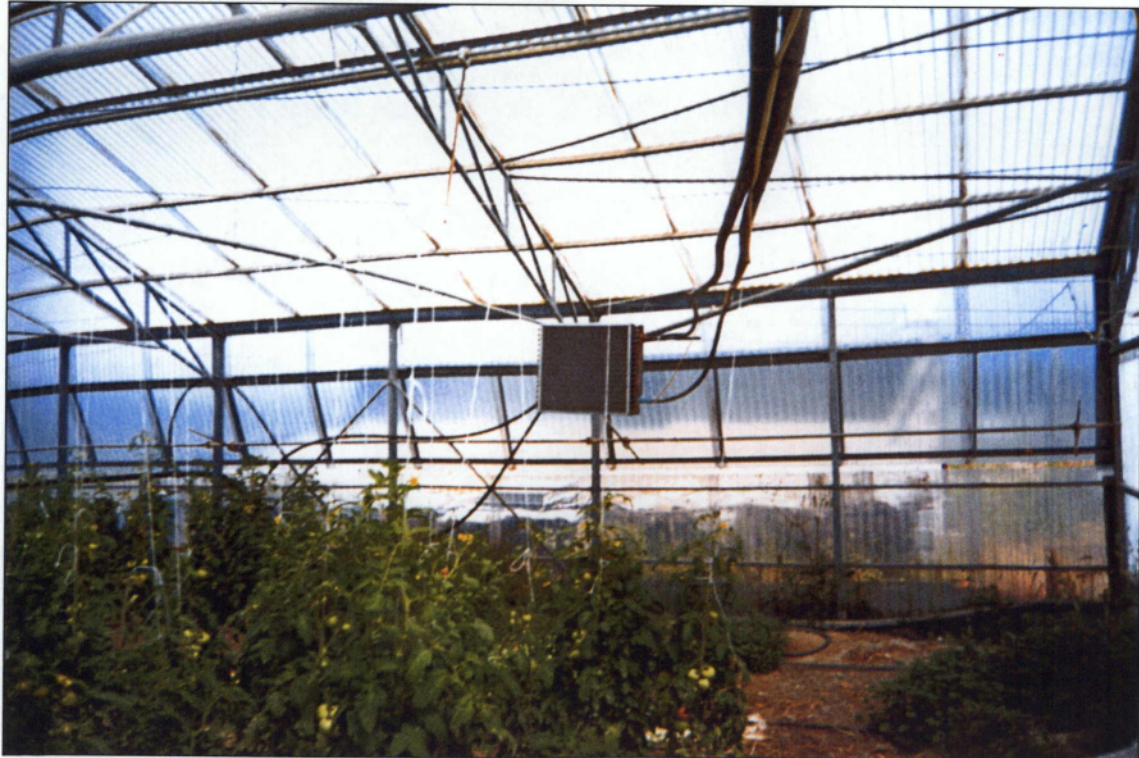
Εικόνα 12. Τμήμα χρήσης του συστήματος θέρμανσης του γεωθερμικού ρευστού
