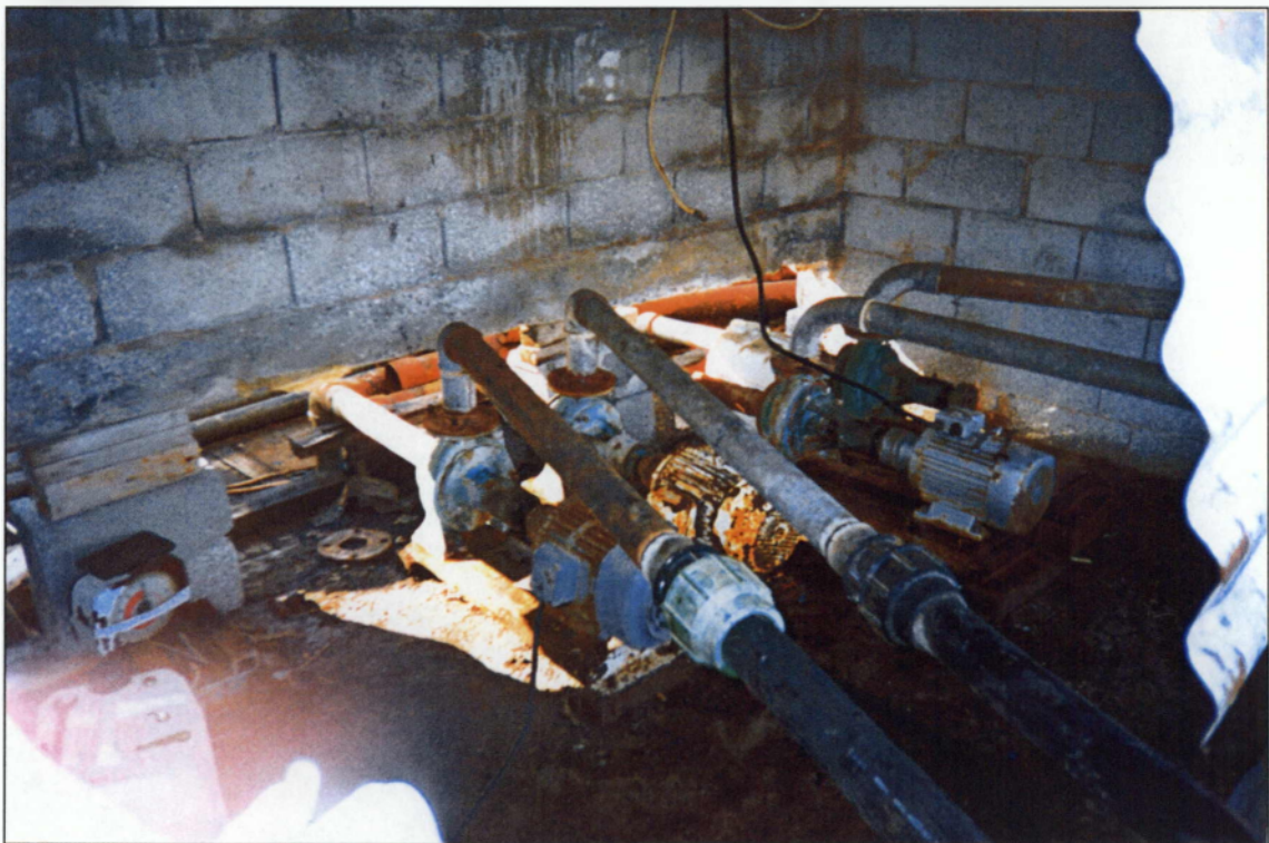
Εικόνα 8. Τμήμα μεταφοράς γεωθερμικού ρευστού
