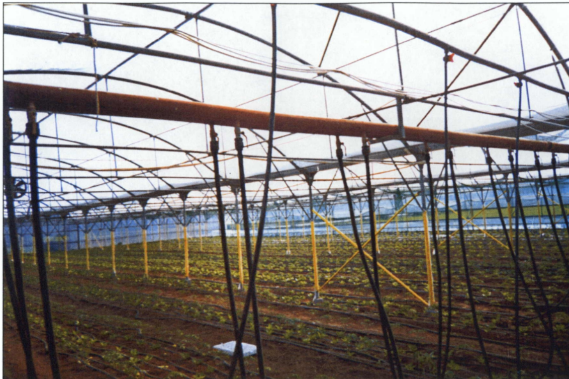
Εικόνα 23. Σωληνώσεις μεταφοράς του θερμού νερού θέρμανσης
